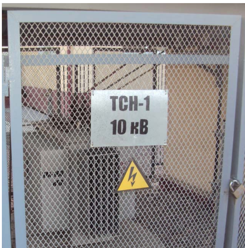
67-rasm. Nimstansiya o'z extiyoji transformatori.
