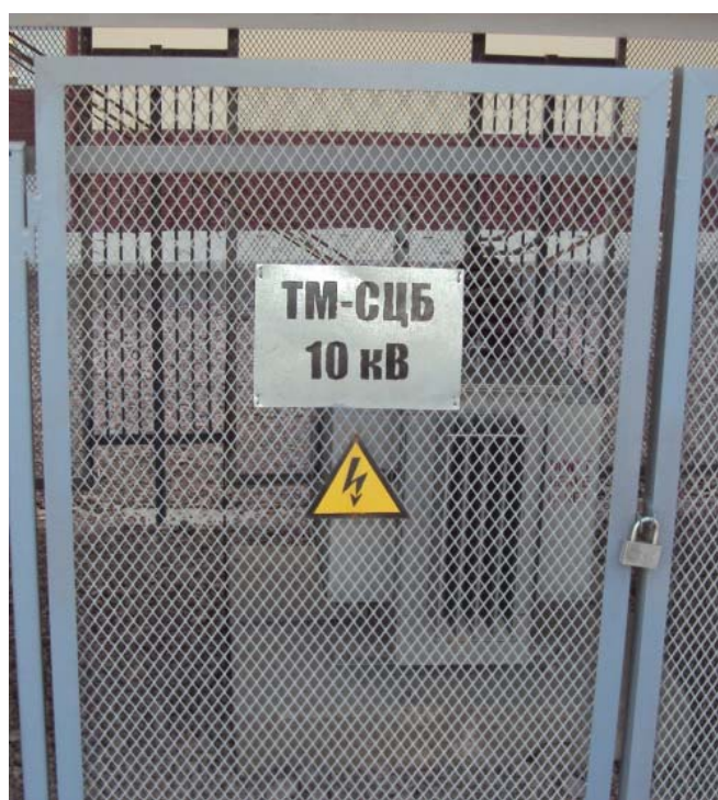
68-rasm. Nimstansiya CЦБ transformatori.
